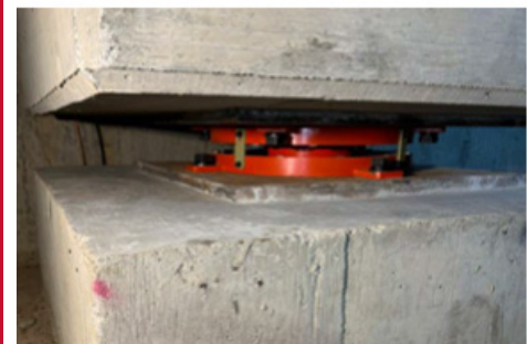
Aislador sísmico instalado
