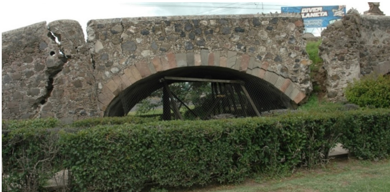
Daños estructurales en un puente de Irapuato provocados por asentamientos diferenciales.
