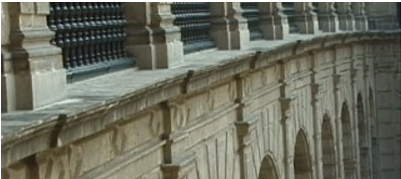
Deformación convexa provocada por asentamientos diferenciales
