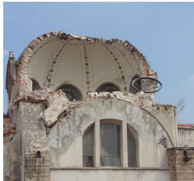
Colapso de cúpula (fuente: B. Carrillo y G. Picazo; UAZ).
